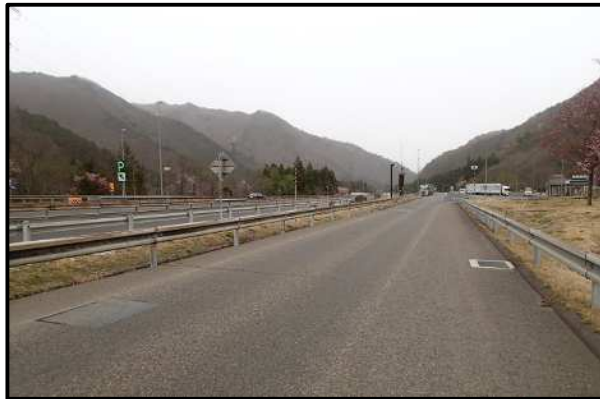
舗装損傷写真
